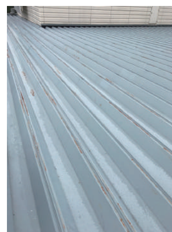
下地 (劣化状態)
