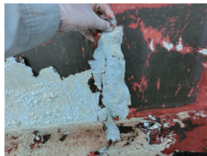
剥離後の塗膜
