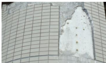
タイルの剥落
