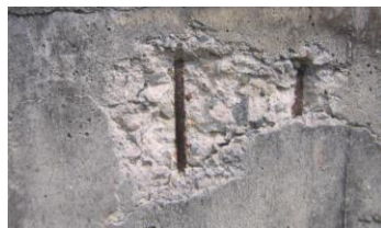
コンクリートの欠損
