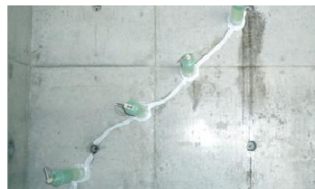
コンクリートのひび割れ
