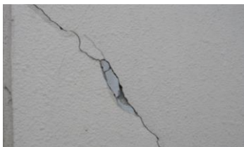
コンクリートのひび割れ
