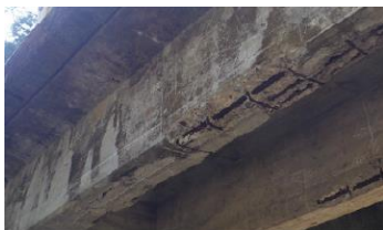
コンクリートの剥落
